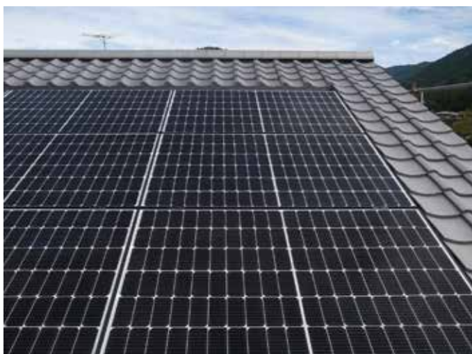
写真 18 左側の屋根に太陽光発電パネルを設置。地上での目線では 見えないこともあり、まったく違和感はない。 （設計：堀部安嗣建築設計事務所） © 堀部安嗣
